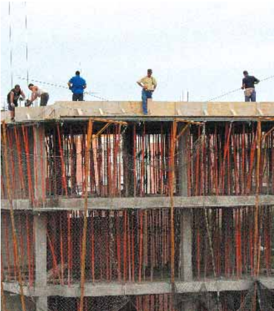
BAU. Das Gesetz führt eine weitere Person zur Qualitätskontrolle ein. / SUR
